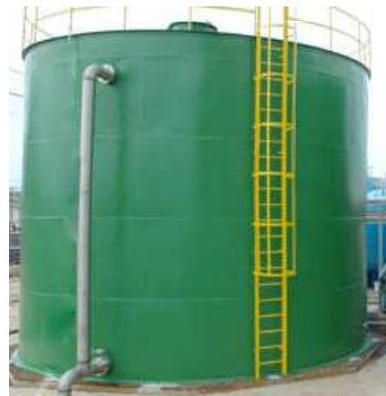
Bể chứa xăng dầu
