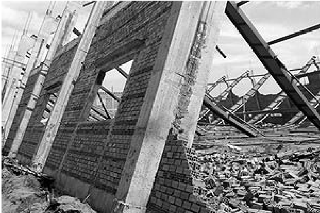
Hình 1.8 Sự cố công trình Công ty dệt may Hoà Khánh thuộc khu CN Lê Minh Xuân – Bình Chánh – TP Hồ Chí Minh
